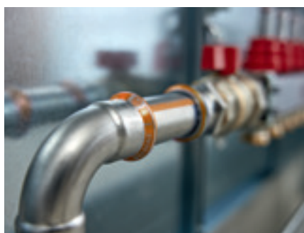
Marquage supplémentaire avec le symbole d'avertissement « eau non potable ».
